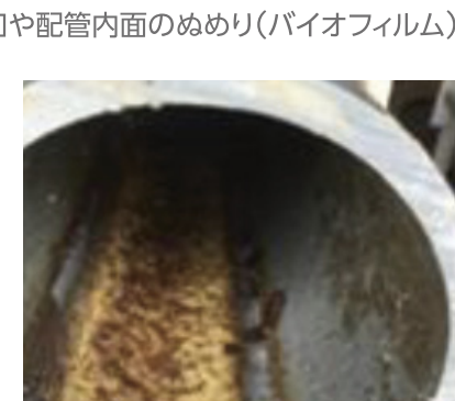
尿石層の両縁がめくれ上り剥離が進んでいる
